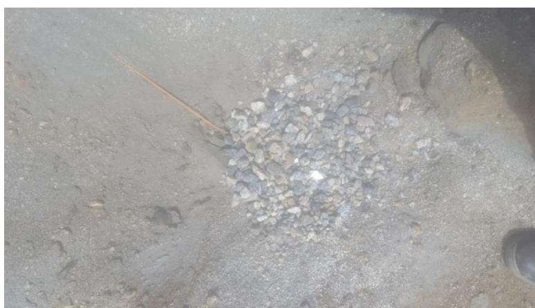
Figura 7: Tampão com brita
